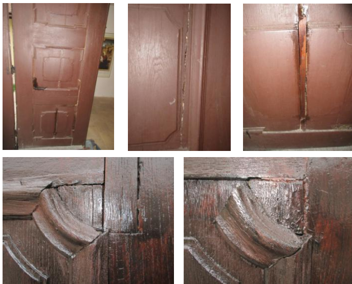
Obr. 2: Atmosférické poškodenia dverí – trhliny a odlúpnutia.
