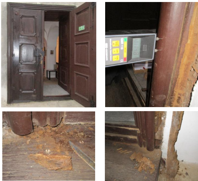
Obr. 1: Biologické poškodenia dverí – hniloba a požerky.
