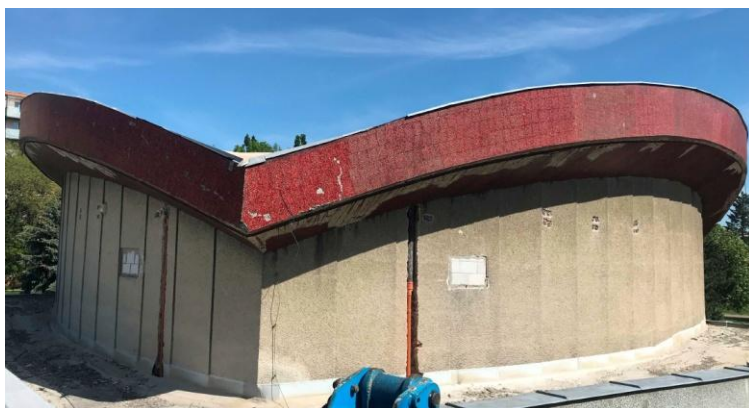
Obr. 8: Pohled na korunní římsu sálu kina Panorex před rekonstrukcí. Ve spodní části římsy je patrná masivní ztráta obkladu. Foto S. Antalová.
